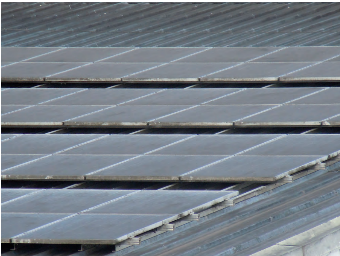
Situation remarquable où le champ photovoltaïque se trouve à proximité d'un incinérateur. Les fumées dégagées par cet incinérateur viennent se déposer sur les modules. Il convient, dans ce cas, de nettoyer régulièrement les panneaux.
