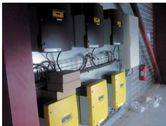
Les onduleurs, les coffrets électriques ainsi que les chemins de câbles occupent de la place dans le local technique.
