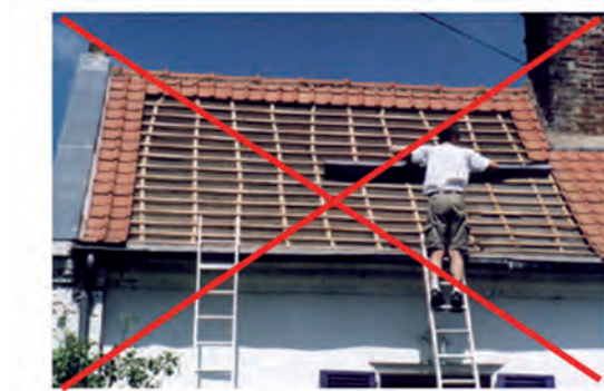
Une échelle n'est pas un poste de travail, mais seulement un moyen d'y accéder.
