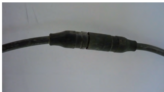
Connecteurs mal branchés susceptibles de produire des arcs électriques.
