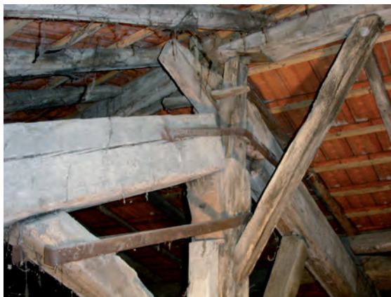
Charpente en mauvais état.
