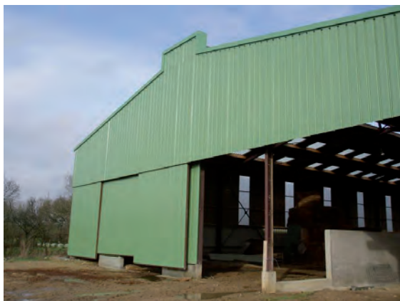
Pour ce bâtiment, il est pertinent de faire établir une étude de la charpente par un bureau d'études structure.
