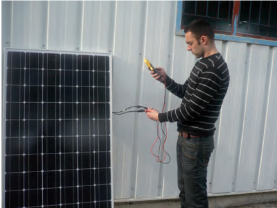
Contrôle de la tension à vide des modules à l'aide d'un multimètre.
